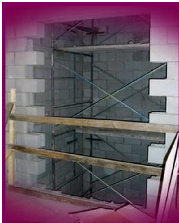
نقشه ۵- اجرای حفاظ ورودی و عدم اجرای دیوارهای مجاور درب
